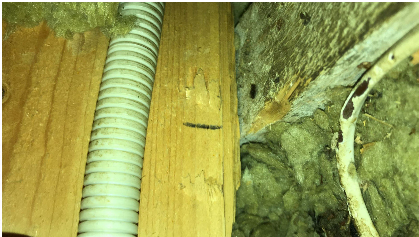
Gnagemerker ble funnet på reisverk, rør og ledninger. Foto: Sondre Solvoll Bakketun
