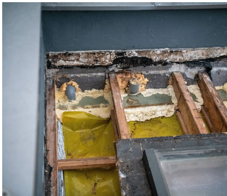
Slik så det ut i et av hjørnene i taket. Blant annet var takbjelkene støpt rett inn i murveggen, noe som ga oppsug av fukt. Her er også et av takvinduene, som ikke var beregnet for å ligge flatt.
