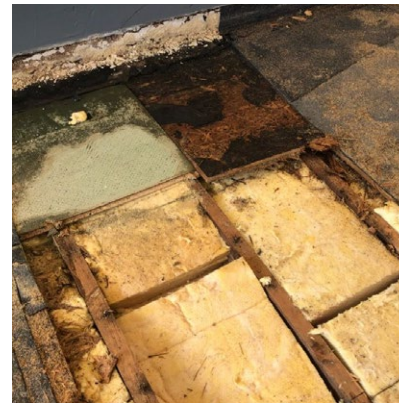
Ifølge huskjøper viser bildet at soppbefengt isolasjon ble lagt tilbake i taket sammen med ny da taket ble åpnet før salg.
