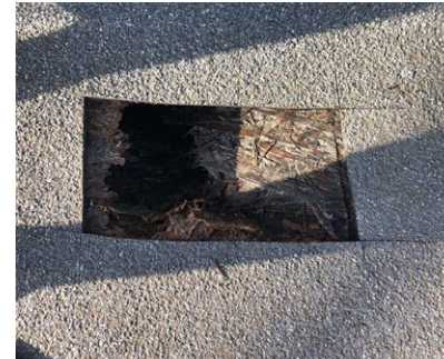
En arbeider fra Byggmester Rygg & Myrland tråkket hull i taket.
