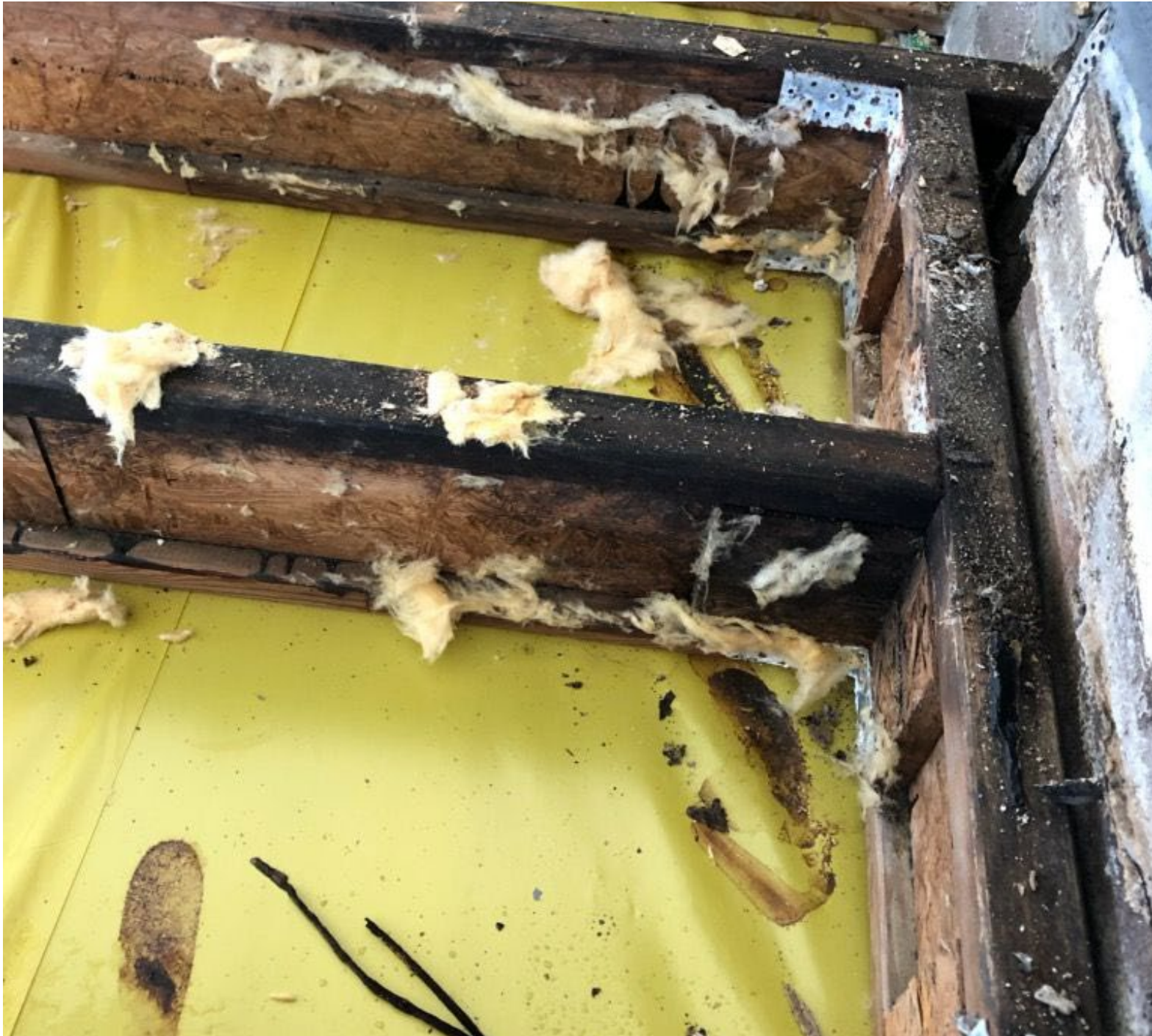
Fuktskadene i drømmehuset på Randaberg viste seg å være omfattende.
