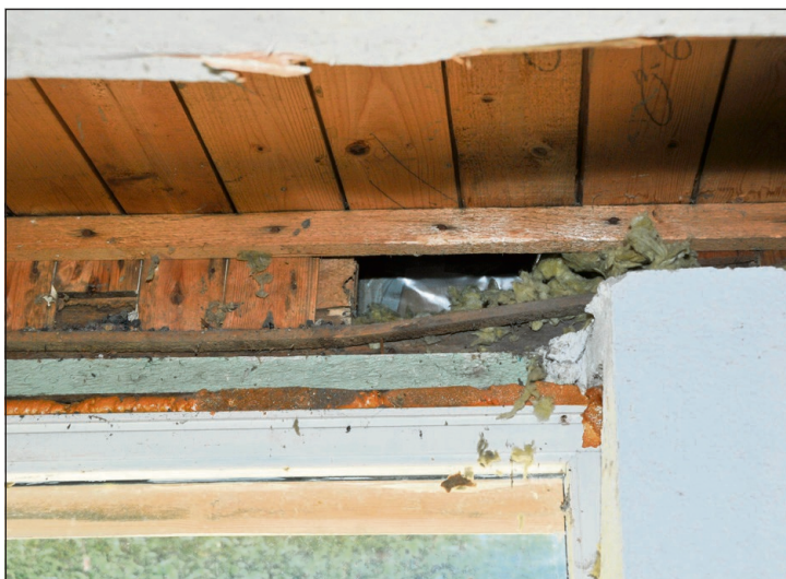
HULL: Takstmann Asle Eidsvold fant et hull i kledningen og vindsperra inn til etasjeskillet, og han mistenker at dette er brukt til å sette inn eller ta ut musefeller eller rottefeller.
