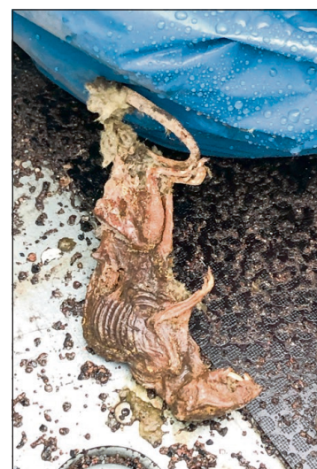
FANT DØDE ROTTER: Pelias fant flere døde rotter i etasjeskillet mellom stua og badstua i kjelleren.
